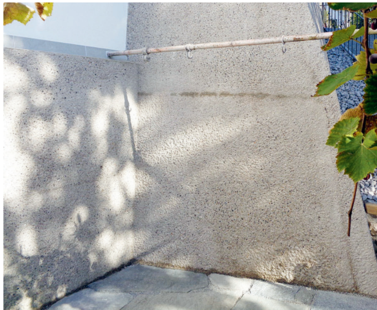
Der Sockel, auf dem das Haus steht, war hohl und musste komplett mit Beton ausgegossen werden. Bild: Ueli Lüthi
