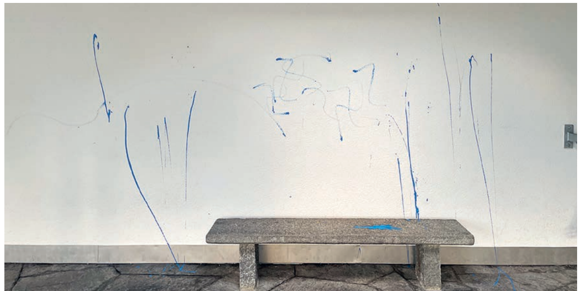
Schmierereien an der Schulhauswand im Zentralschulhaus. Bild: Sjevna Beerli
