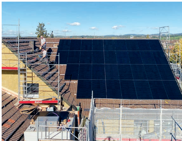
Auf allen Flächen des Mehrfamilienhauses an der Binzikerstrasse 10 installiert die Baugenossenschaft Photovoltaik-Anlagen.
