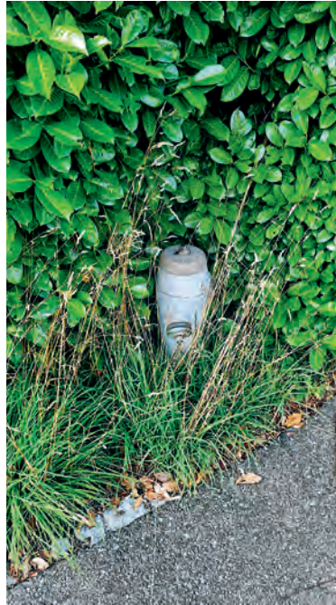
Die stillen Helfer der Feuerwehr, die Hydranten, sollten immer freigelegt sein. Bild: Lukas Bänziger
