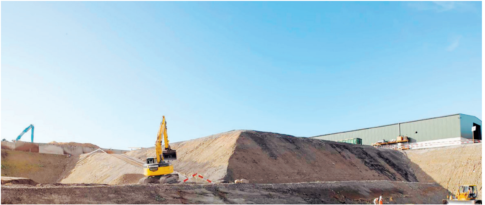
Geht es nach den Plänen der Baudirektion, soll man im Tägernauerholz bald Bagger statt Vogelgezwitscher hören (Symbolbild).
